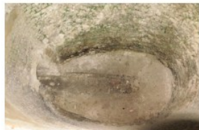
Ein Blick in die Brennkammer.
